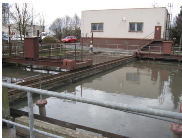
Příloha č. 9: Usazovací nádrže
