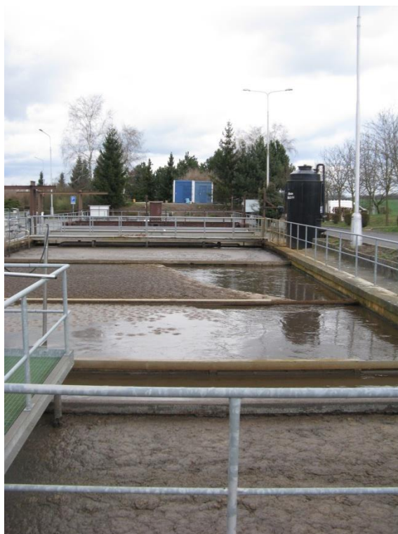
Příloha č. 12: Denitrifikační a nitrifikační nádrže
