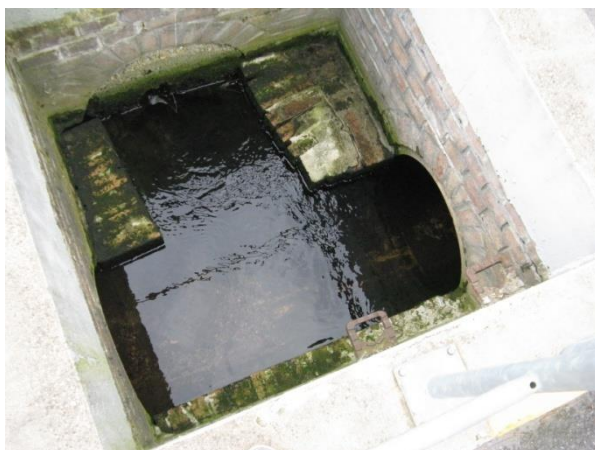
Příloha č. 15: Soutok vyčištěné vody z obou dosazovacích nádrží
