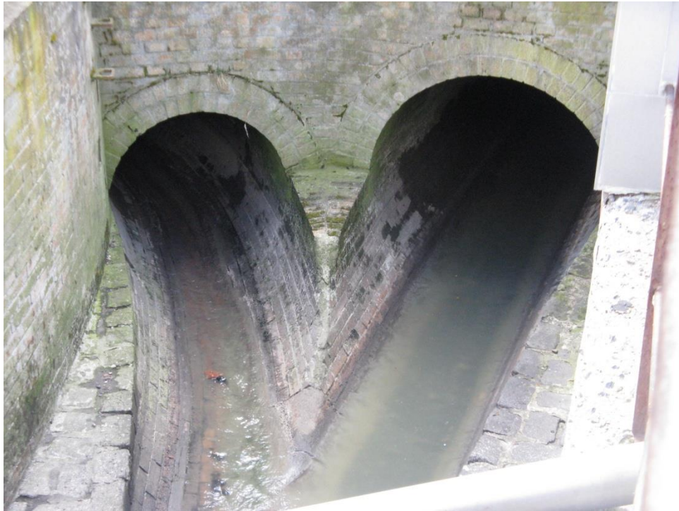
Příloha č. 1: Přítok odpadní vody na čistírnu (vlevo Satalice, vpravo Kbely)
