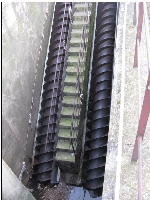
Příloha č. 5: Šneková čerpadla v čerpací jímce
