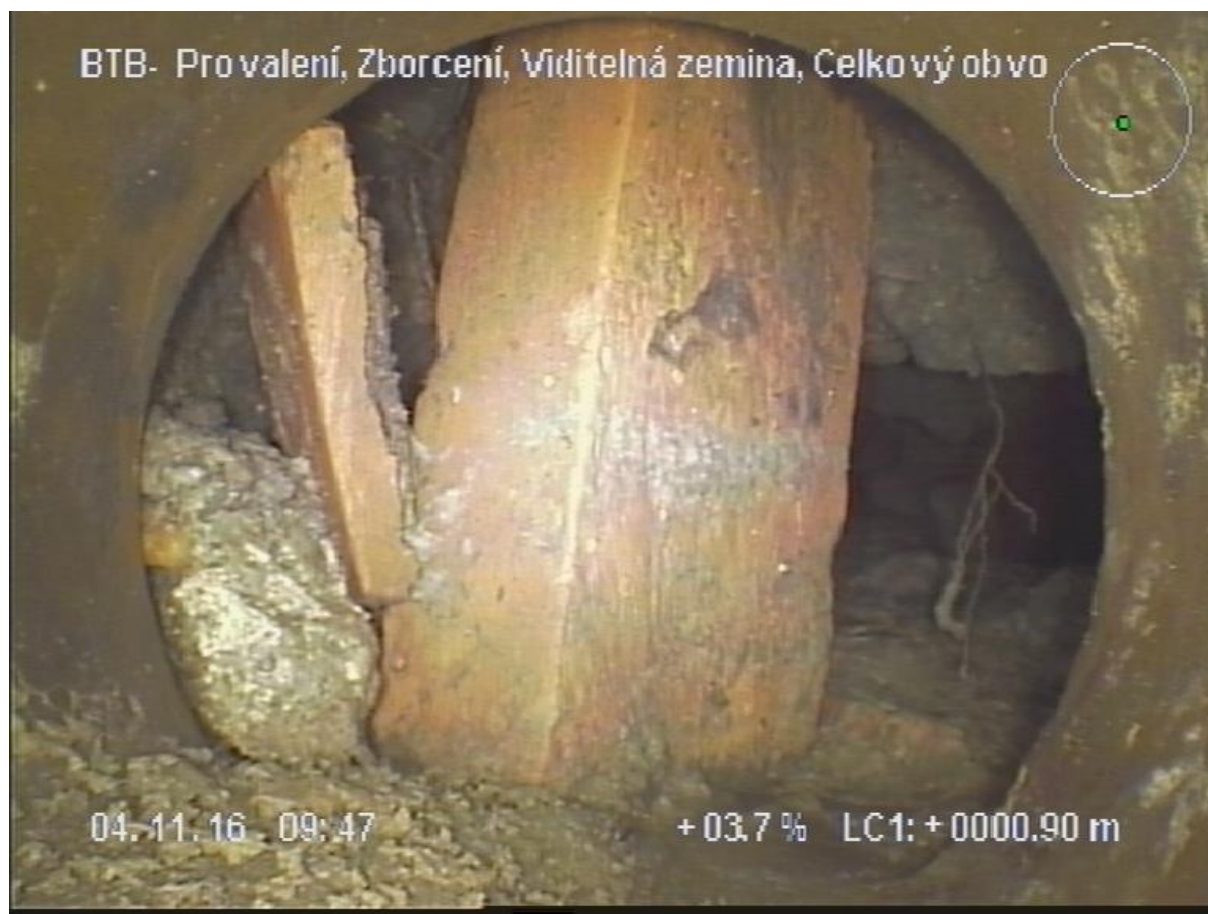
Obr. 7.13 Obrázek z kamerového průzkumu [11]
