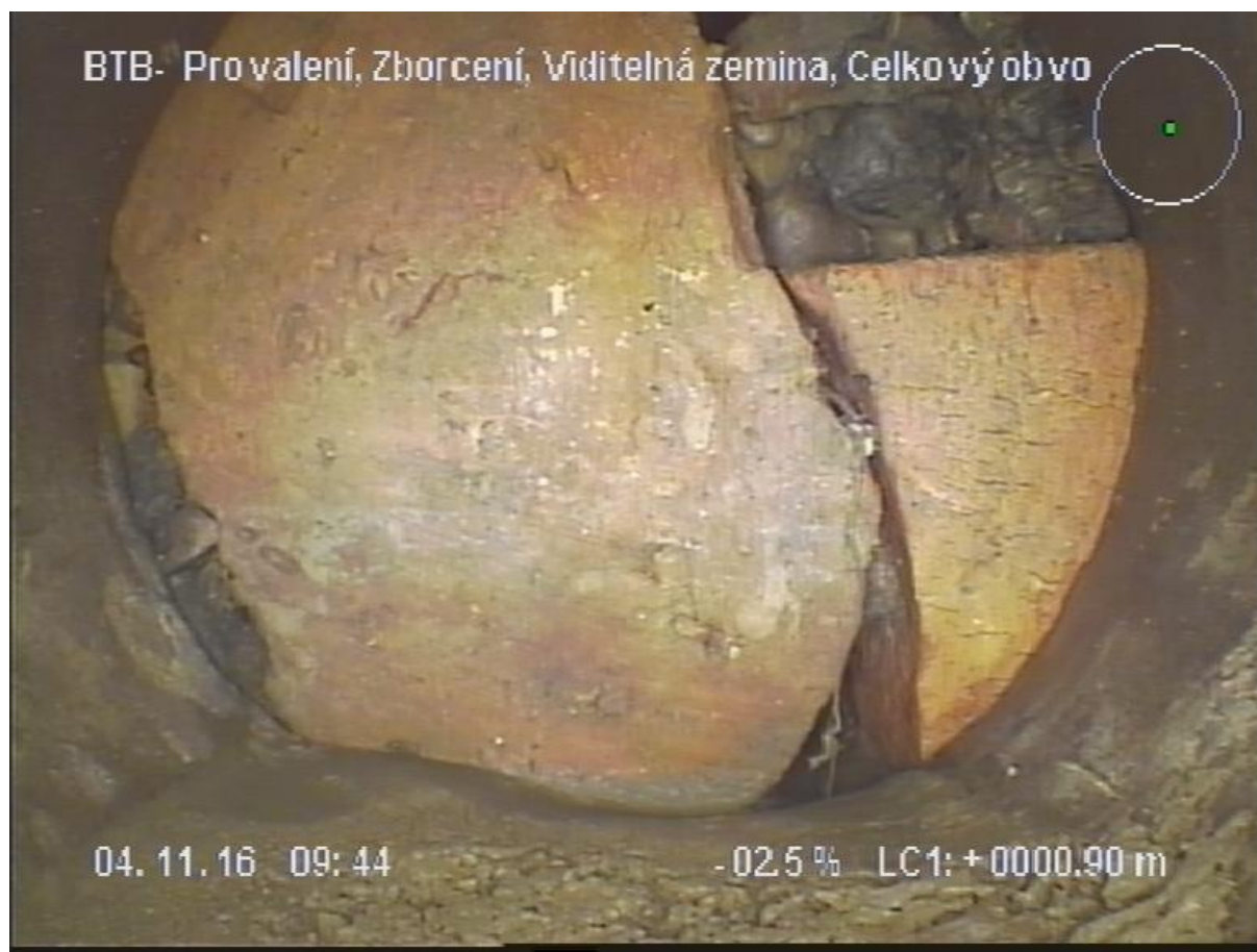
Obr. 7.14 Obrázek z kamerového průzkumu [11]
