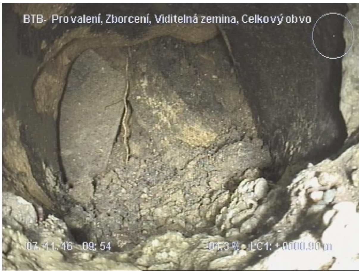
Obr. 7.12 Obrázek z kamerového průzkumu [11]
