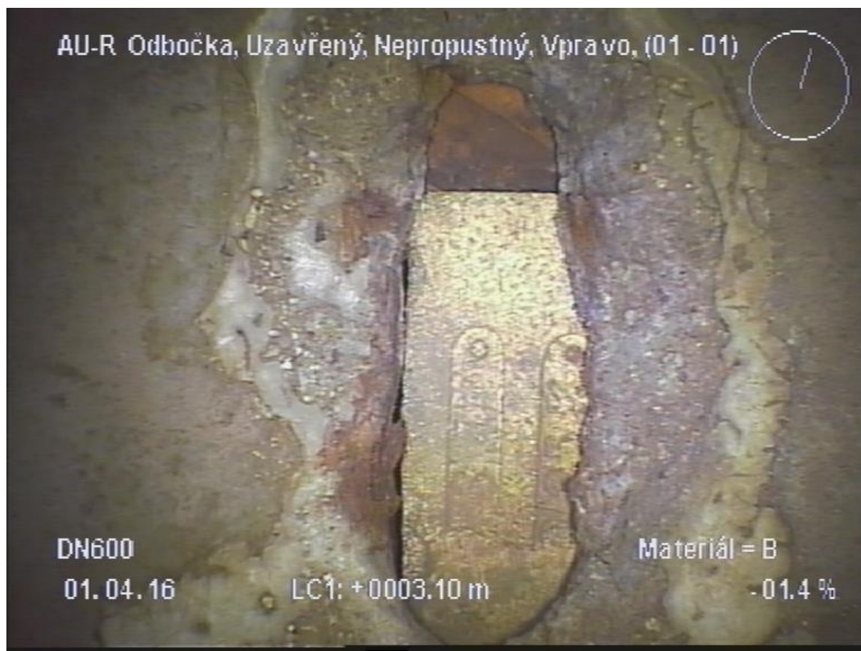
Obr. 7.7 Obrázek z kamerového průzkumu [11]
