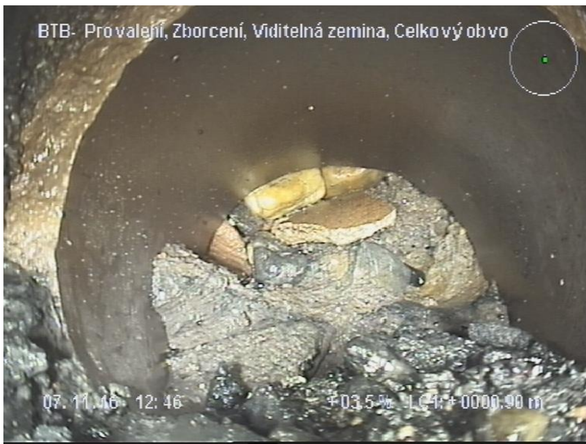
Obr. 7.29 Obrázek z kamerového průzkumu [11]
