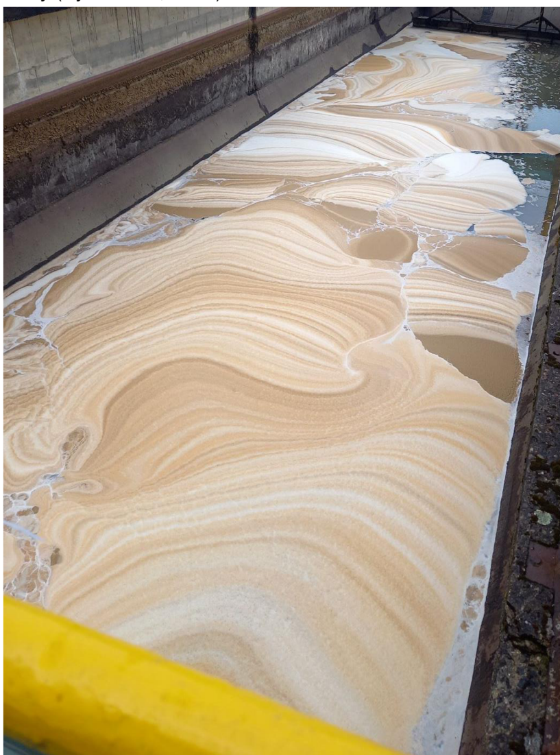
Obrázek 6: Sedimentační zdrž s mostovými shrabováký
