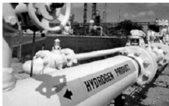
Obrázek 24 Potrubí přepravující vodík v Texasu ve Spojených Státech Amerických [44]
