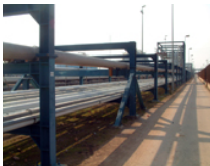
Obrázek 23 Potrubí transportující vodík (Plynovod) [27]
