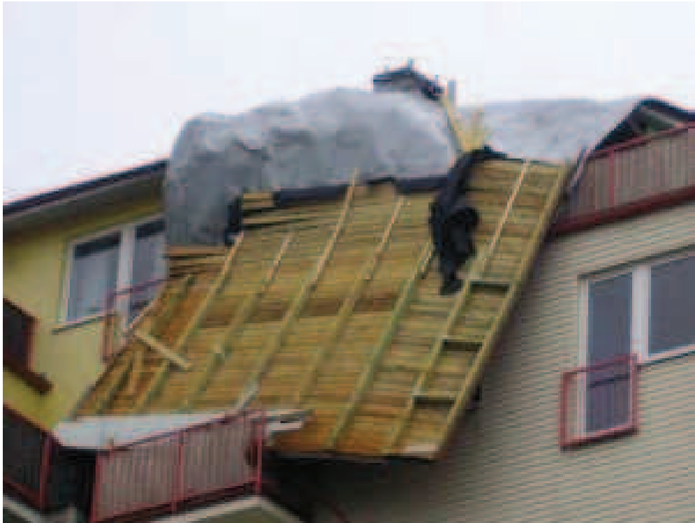
Obr. 29 Stržená střecha bytového domu (34)
