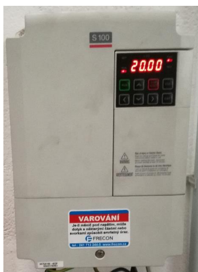
Obr. 42 Odsávací ventilátor – spouštěcí a řídicí skřín
