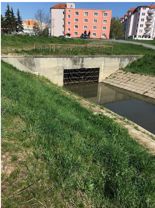
Obr. 5: Ústí kanalizace do řeky Moravy u silničního mostu u „kojeneckého ústavu“ (Filip Coufal, duben 2016)
