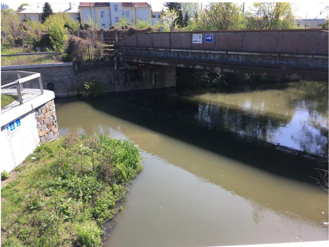
Obr. 38: Železniční most při soutoku Mlýnského potoka obtokového kanálu u galerie „Šantovka“ (Filip Coufal, duben 2016)
