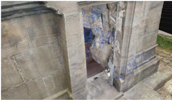
Obrázek 23: Deformovaný prostor kaple 172
