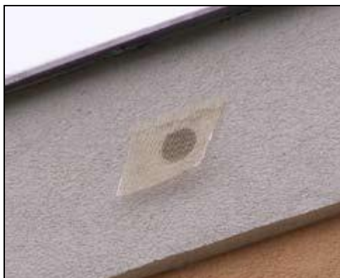
Obr. 4. Preventivní překrytí ventilačního průduchu závěsem z perlinky (Mach, J., 2008). Instalace však není zcela správná – perlinka by se neměla odchlípnout ode zdi, ale být k ní volně přiložená
