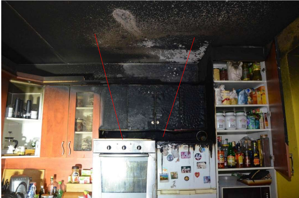
Obrázek č. 12 – ohniskový kužel, který vznikl při požáru kuchyňské linky od svíčky. 36
