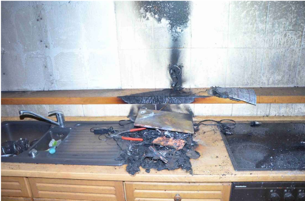
Obrázek č. 2 – Porušení návodu výrobce – ponechání el. cigarety při dobíjení v zásuvce bez dozoru. 11
