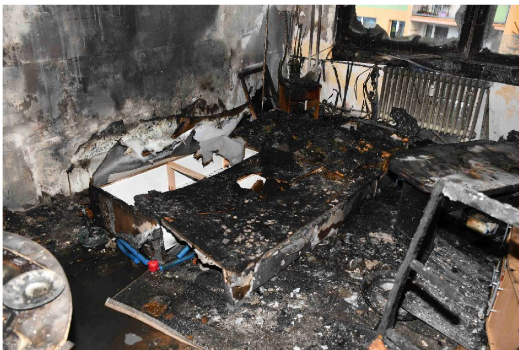
Obrázek č. 8 – požární ohnisko. 25
