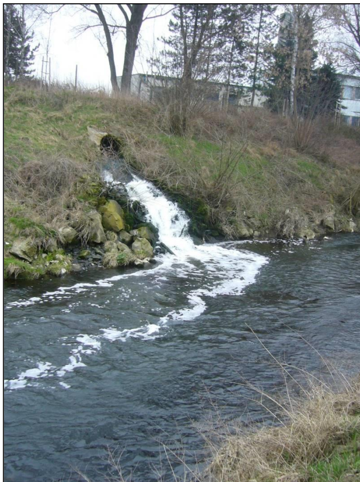
Příloha 12: Výpusť z ČOV do Dřevnice, vlastní foto
