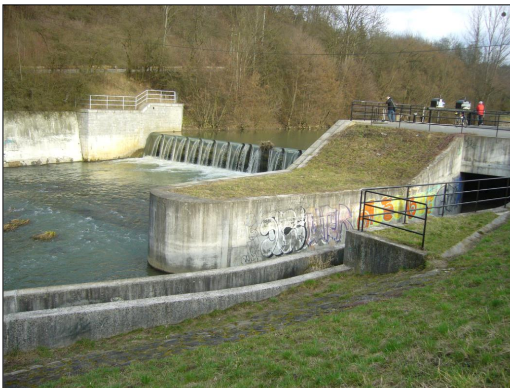
Obr. č. 23: Pohyblivý jez na Dřevnice, část Zlín-Příluky, vlastní foto
