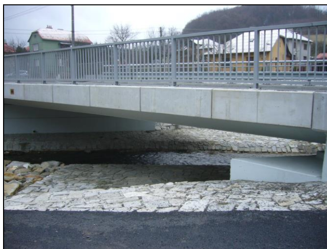
Obr. č. 17: Zrekonstruovaná mostní konstrukce přes Dřevnici v obci Kašava, vlastní foto
