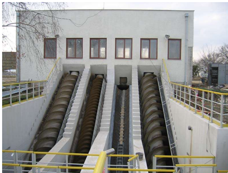
Obr. 5 Čerpadla s Archimédovými šrouby na přítoku odpadní vody do ČOV [57].
