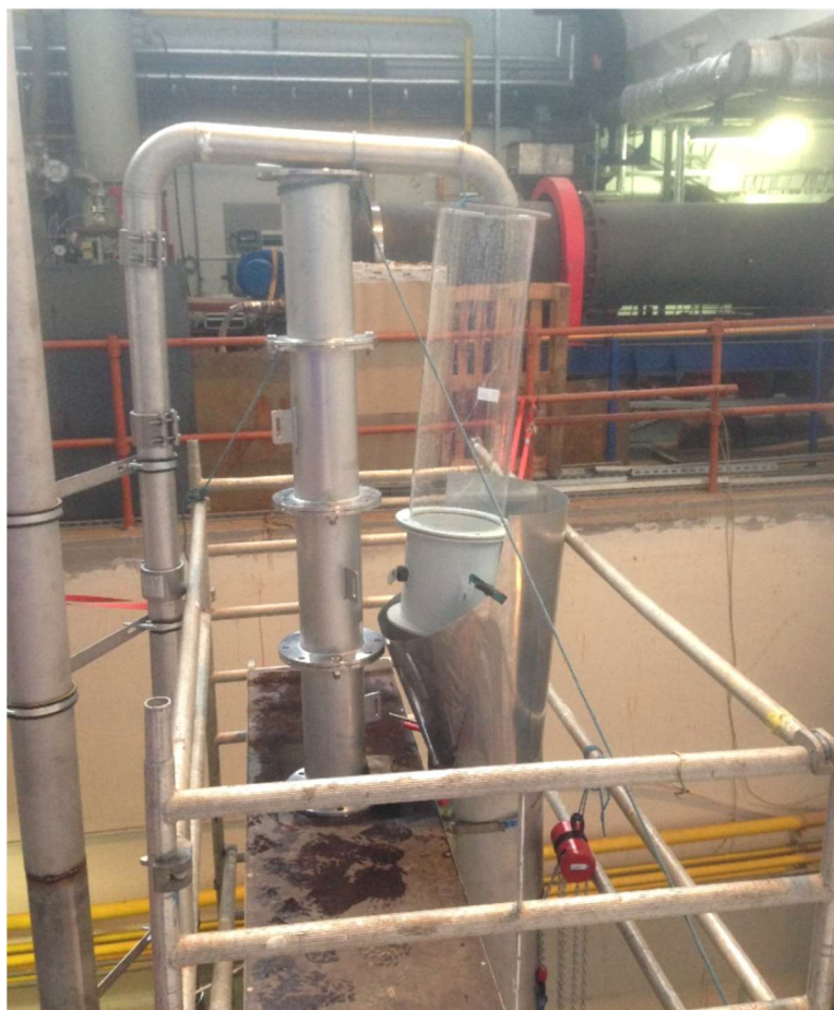
Obr. 21 Zavěšené plastové potrubí.
