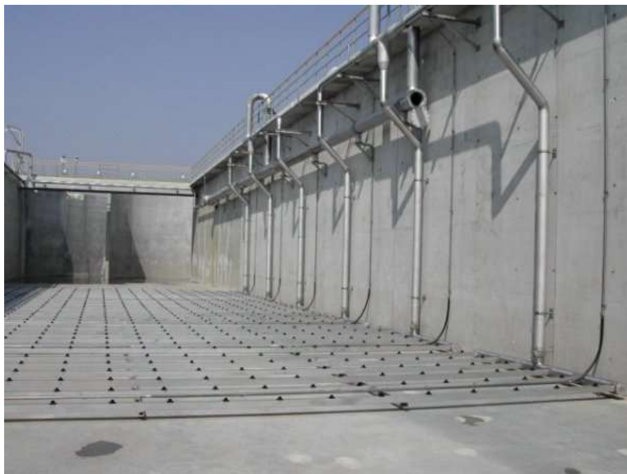
Obr. 11 Instalované aerátory v nitrifikační sekci [57].
