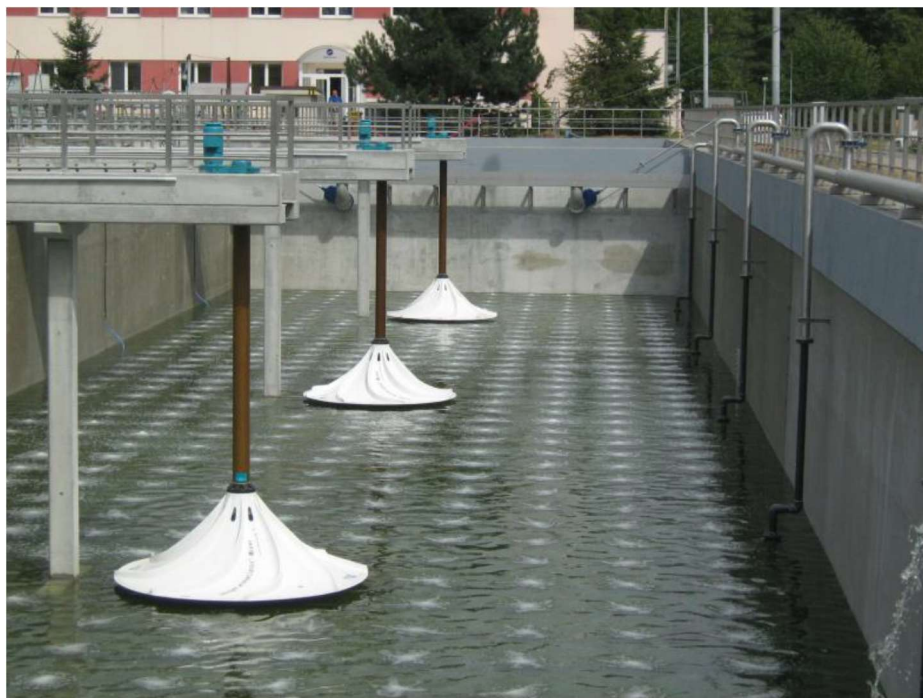
Obr. 12 Instalovaná míchadla v denitrifikační sekci [63].
