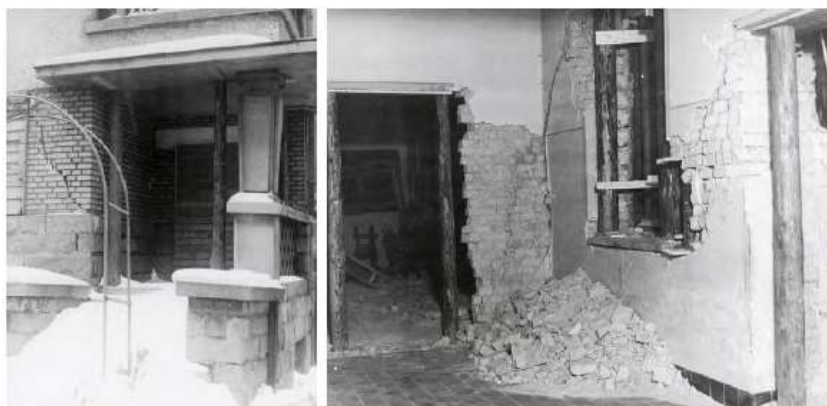
Obr. 8: Trhliny zniklé poddolováním na školní budově – rok 1942 (Drápela et al. 2018).
