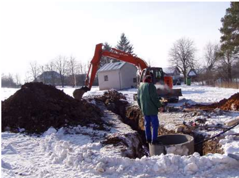
Foto č. 6: Realizace přípojky z nového vrtu do budovy s čerpací stanicí (S2), odkud se čerpá voda do vodojemu
