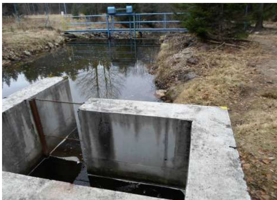
Foto č. 8: Odběrný objekt na Třítrubeckém potoce
