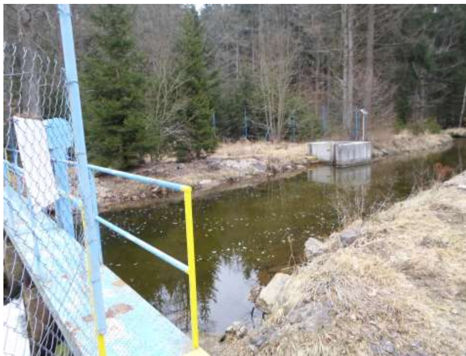
Foto č. 7: Ochranné pásmo jímacího místa na Třítrubeckém potoce, vzdouvací objekt, odběrný objekt
