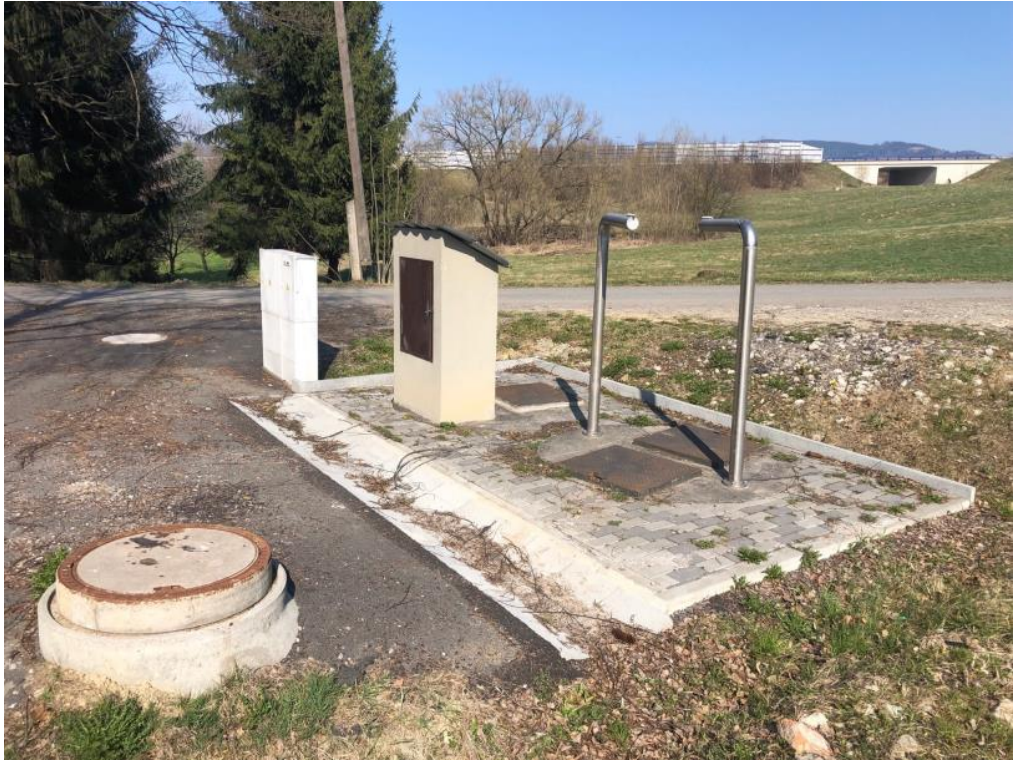
Obrázek 10 Přečerpávací stanice obce Bocanovice, pohled zvenku (Zdroj: vlastní foto)
