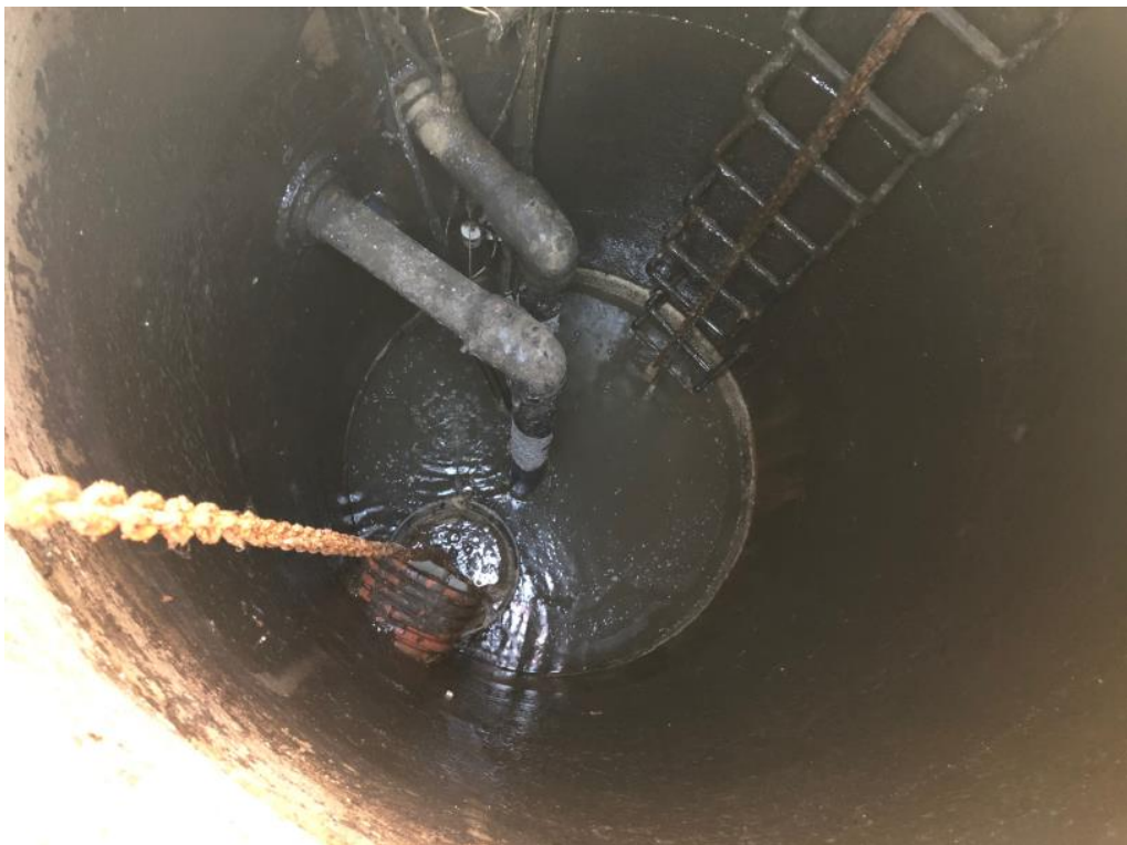
Obrázek 11 Přečerpávací stanice obce Bocanovice, pohled zevnitř (Zdroj: vlastní foto)
