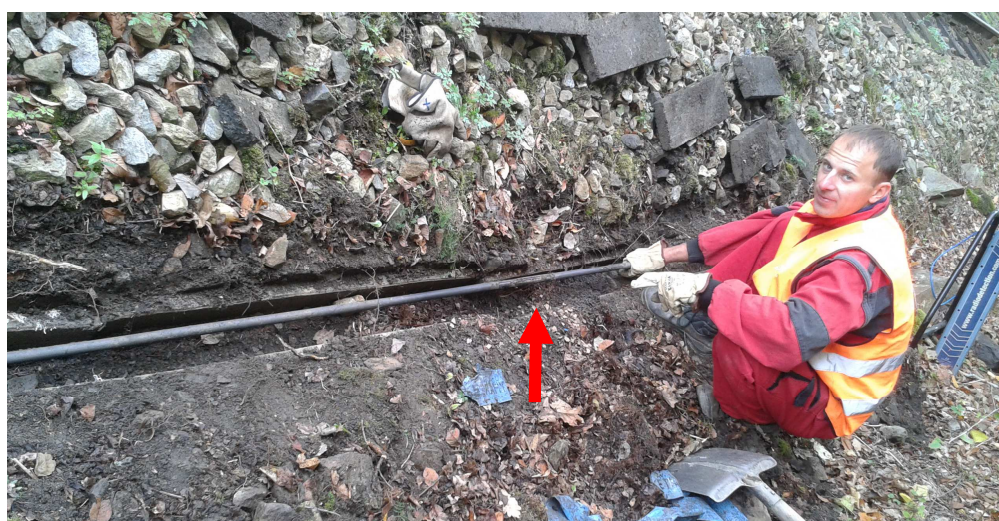
Obr. 8.33 Místo poškození kabelu
