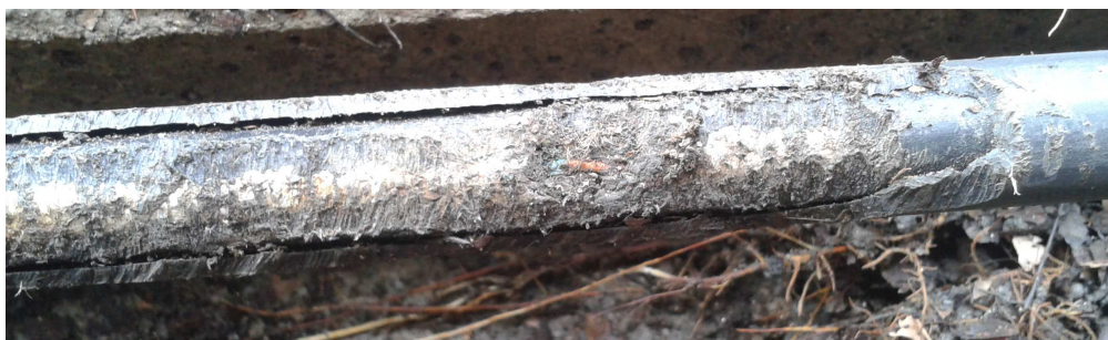
Obr. 8.34 Detail ohlodaného kabelu
