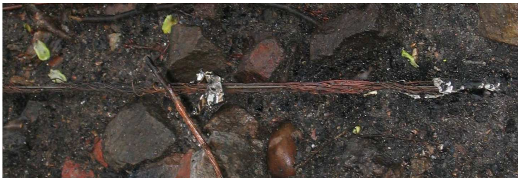
Obr. 8.13 Detail spáleného kabelu
