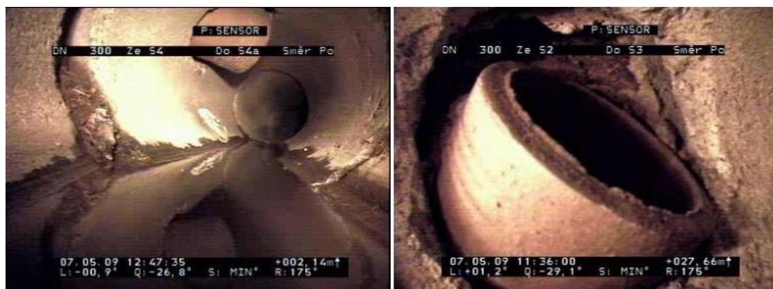
Obr. 2 Neodborné napojení odbočky (příklad špatného provedení stavebních prací) [5]
