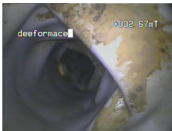
Obr. 3 Zdeformované plastové potrubí vlivem špatné pokládky nebo během neodborného hutnění bez správného zásypu.[5]
