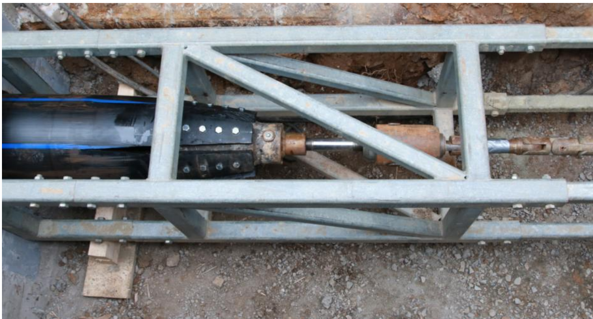
Obr. 30 Sanace potrubí metodou Swageling v Praze Dejvicích firmou ZEPRIS s.r.o. - výstupní část zobrazující tažnou hlavu.
