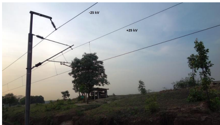
Obrázek 6: Pozemní vedení 2 AC 25 kV, 50 Hz [14]
