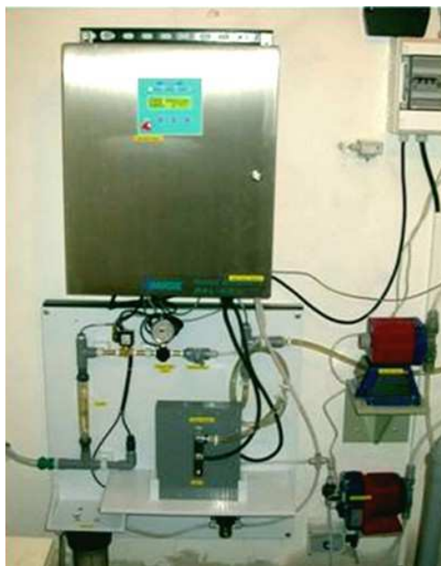
Obr. 3.10 Úpravna vody Vysoká Pec. Pohled na zařízení SAL-40 pro výrobu chloru s kapacitou 1,8 kg volného aktivního chloru za den [31]
