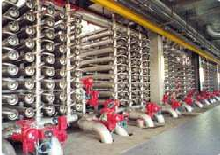
Obr. 3.7 Nanofiltrační jednotky na ÚV Méry sur Oise [25]
