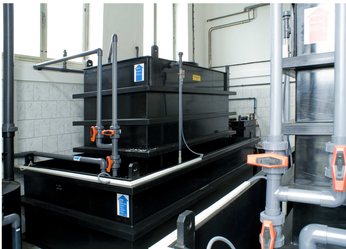
Obr. 3.2 Pohled na zásobníky chemikálií pro výrobu chlordioxidu ÚV Milence [30]
