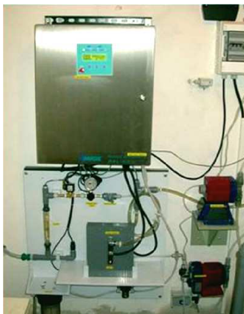
Obr. 3.10 Úpravna vody Vysoká Pec. Pohled na zařízení SAL-40 pro výrobu chloru s kapacitou 1,8 kg volného aktivního chloru za den [31]
