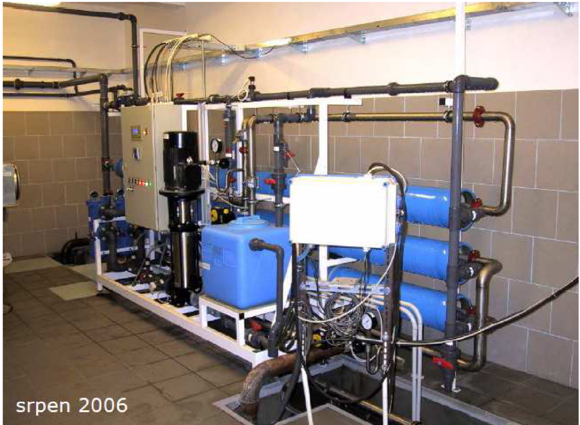
Obr. 3.9 Úpravna vody Třebotov [37]
