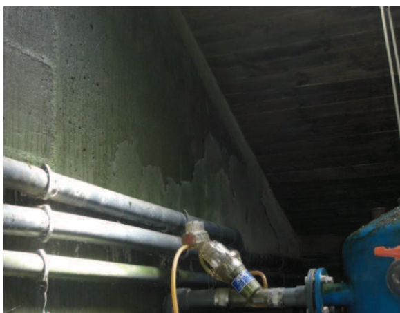
Obr. 52 Koroze napadená stěna
