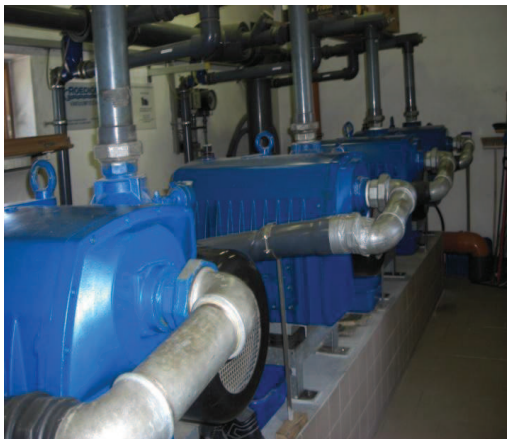
Obr. 59 Vývěvy v podtlakové stanici
