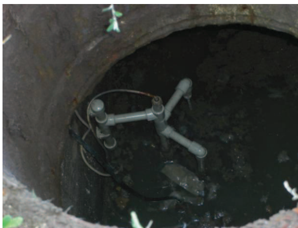
Obr. 14 Čerpadlo se senzory umístěné v septiku
