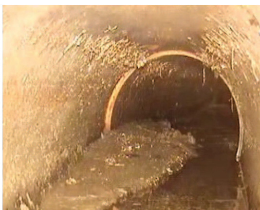
Obr. 83 Trhliny a deformace potrubí
