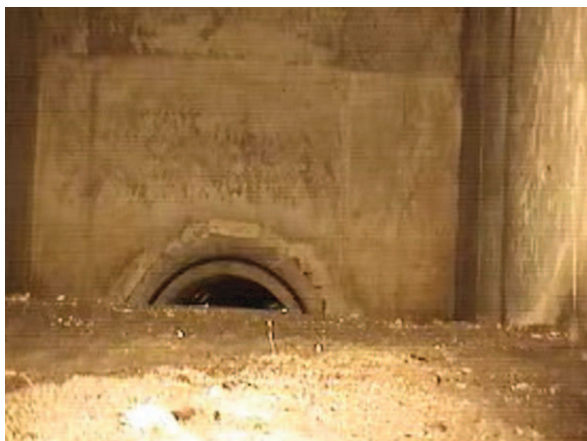
Obr. 23 Sedimenty v potrubí
