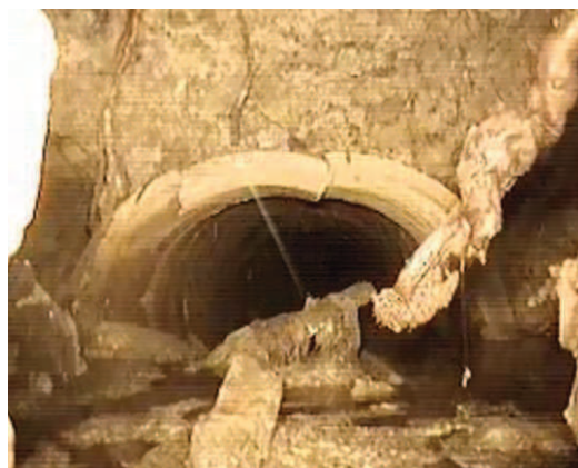
Obr. 22 Zborcení betonové trouby
