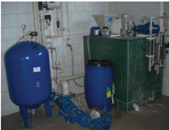
Obr. 46 Nádrže pro dávkování flokulantu
