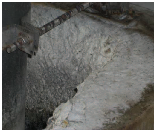
Obr. 20 Působení koroze na betonovou nádrž na ČOV
