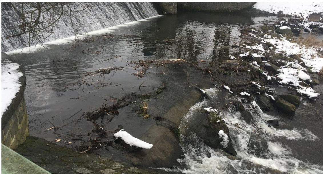
Obr. 6.2 – Zanesené dno za vývaříštěm
