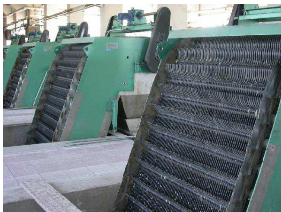
Obrázek č.4 Linka samočistících česli Brno - Modřice [8]
