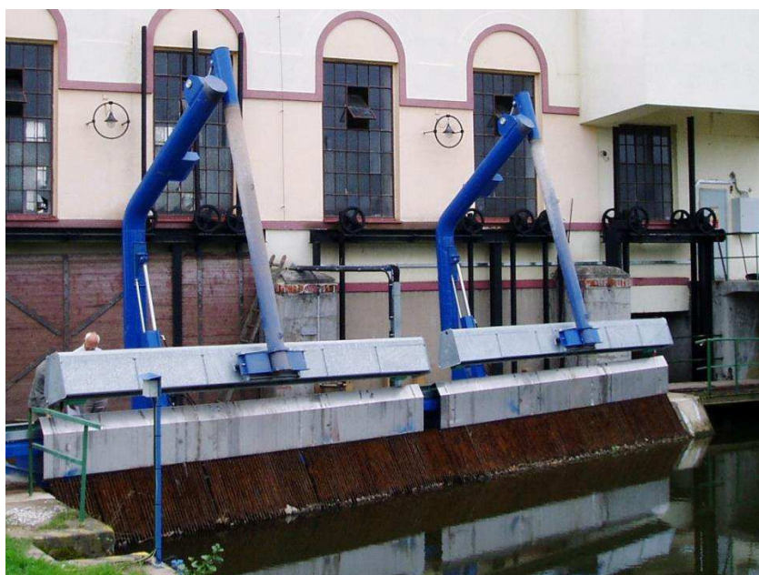
Obrázek č.7 Česle firmy P&S a.s. na lokaci MVE Bakov [10]
