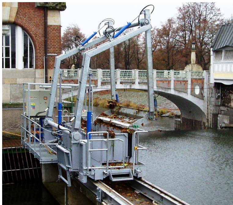
Obrázek č.8 Česle firmy P&S a.s. na lokaci MVE Hučák [11]
