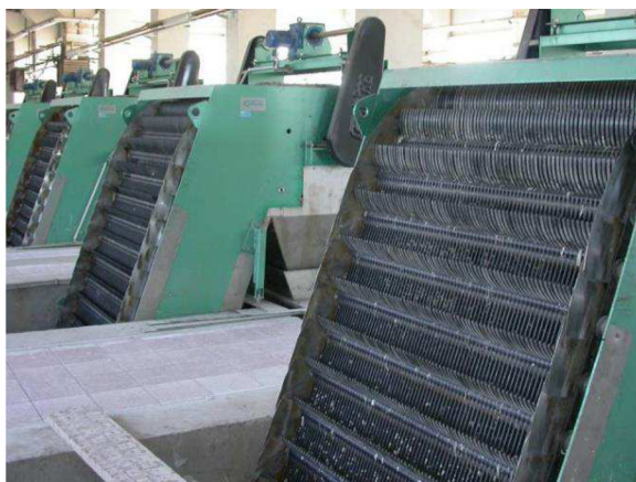
Obrázek č. 4 Linka samočistících česli Brno - Modřice [8]
