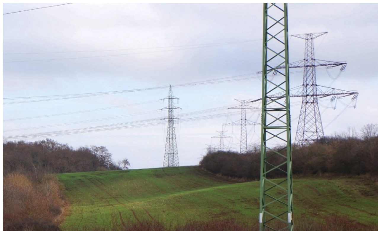
Obr. č. 77: Sloup o 110kV (vlevo) a sloup o 400kV (v pozadí vpravo), foto: autor
