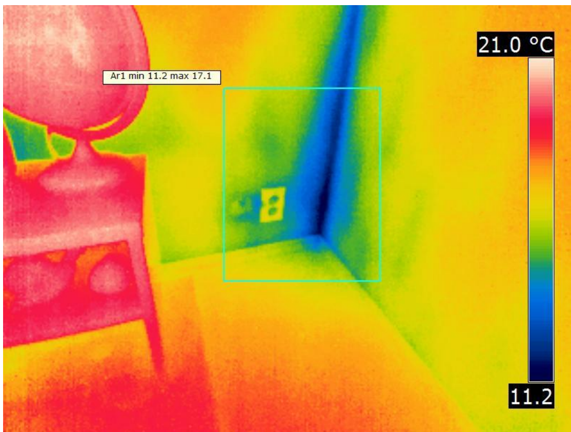
Obr. 31 – Termogram kritického místa s nízkou povrchovou teplotou
