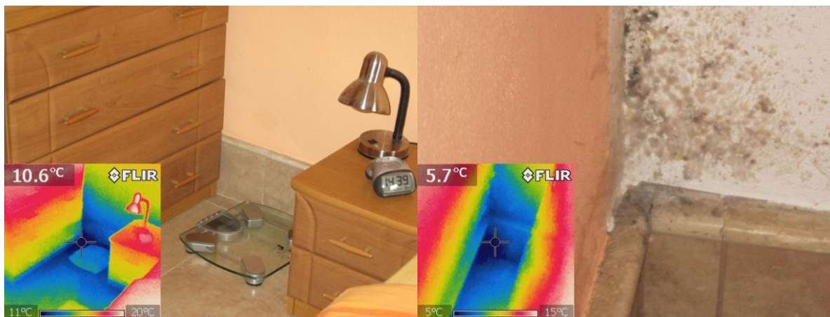
Obr. 13 – Nízká povrchová teplota bez viditelné poruchy (vlevo), shodné místo po odsunu nábytku s již výrazně se projevující poruchou (zdroj: bplus.cz)
