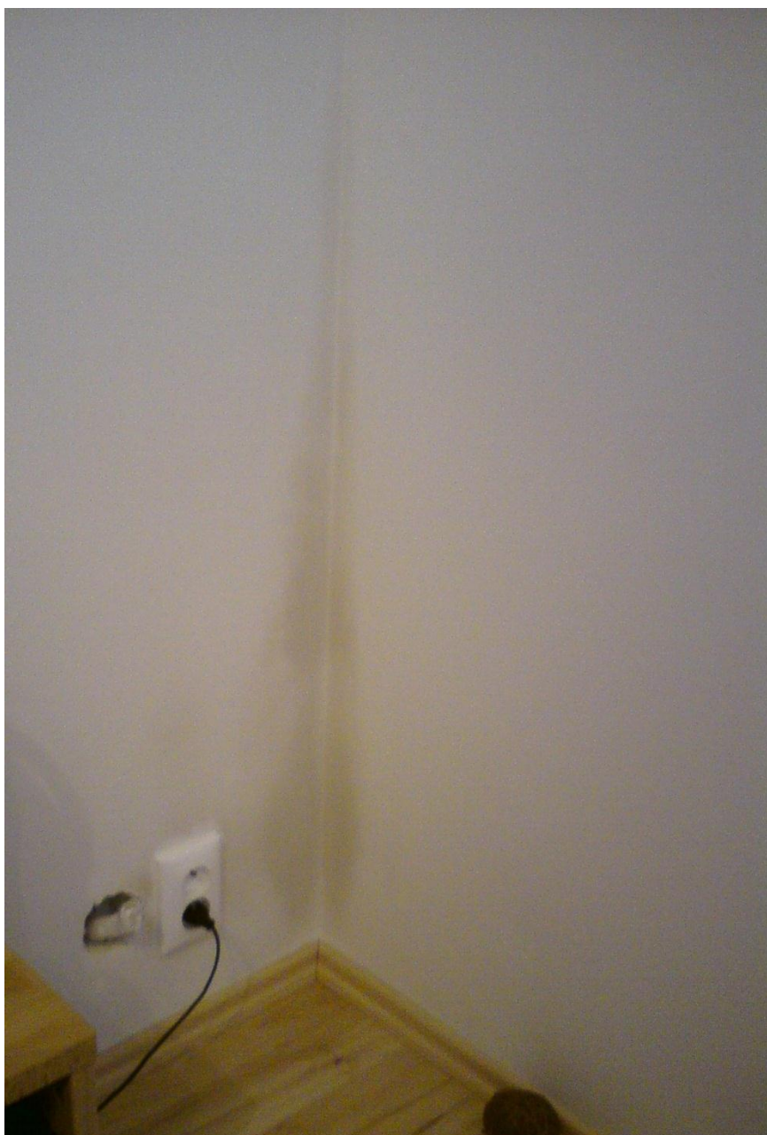
Obr. 29 – Výskyt vlhkosti v rohu obytné místnosti
