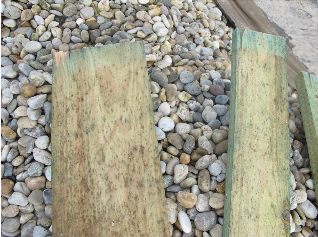
Obr. 22 – Biologická koroze dřevěných prvků nevětrané ploché dvouplášťové střechy vlivem kondenzace v konstrukci
