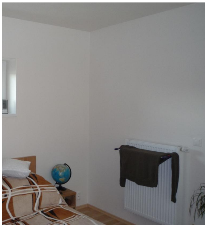
Obr. 30 – Stav rohu předmětné místnosti v den měření
