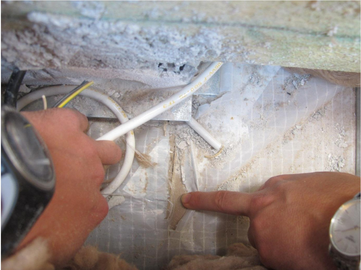
Obr. 21 – Poškozená parozábrana objevená při sondě do střechy
