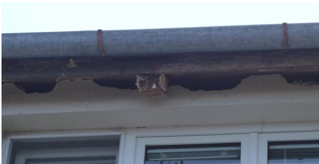
Obr. 9 – ETICS poškozený aktivitou kuny (stav po stržení opláštění přesahu krovu)
