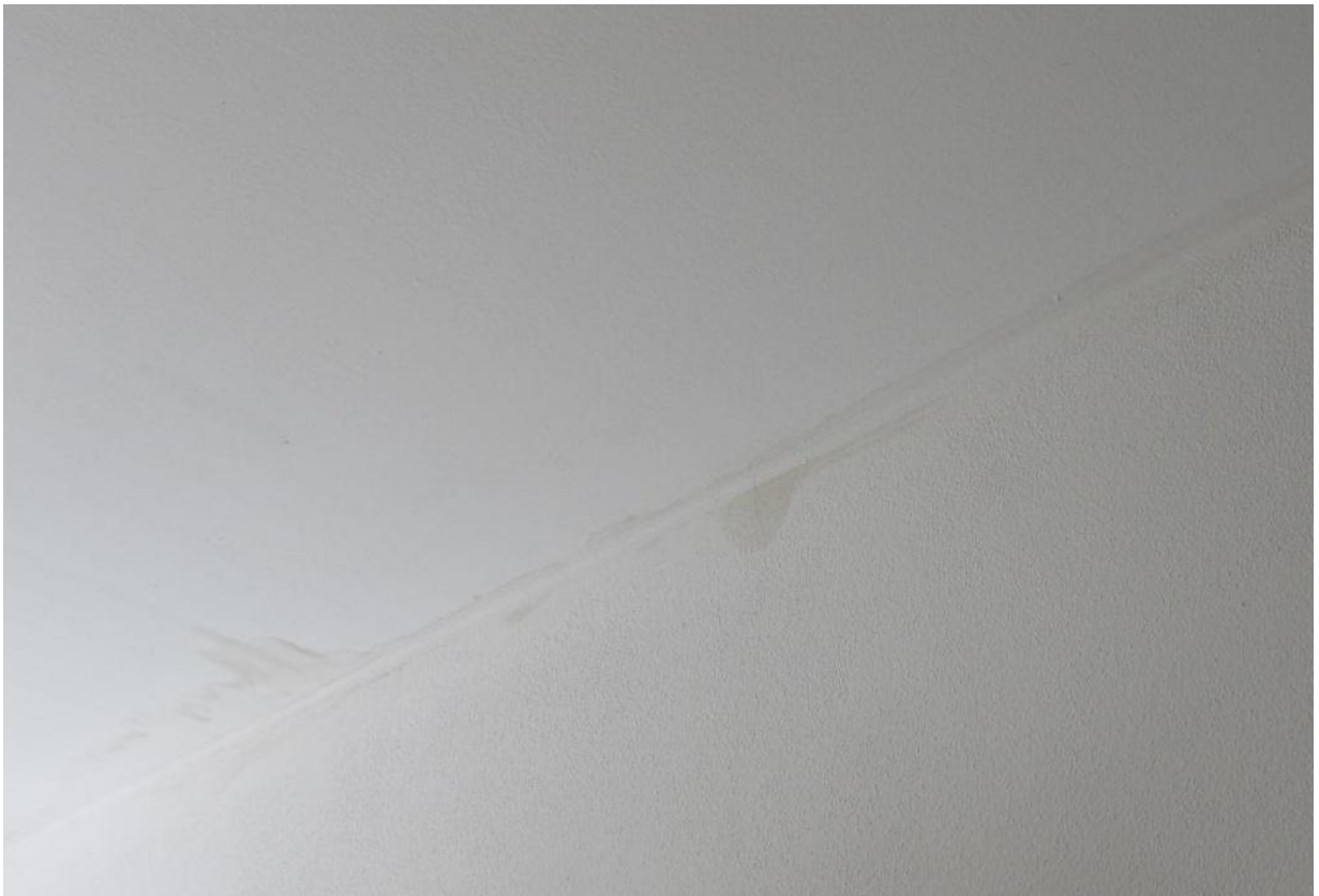
Obr. 20 – Kondenzace v konstrukci dvouplášťové ploché střechy a její projev
