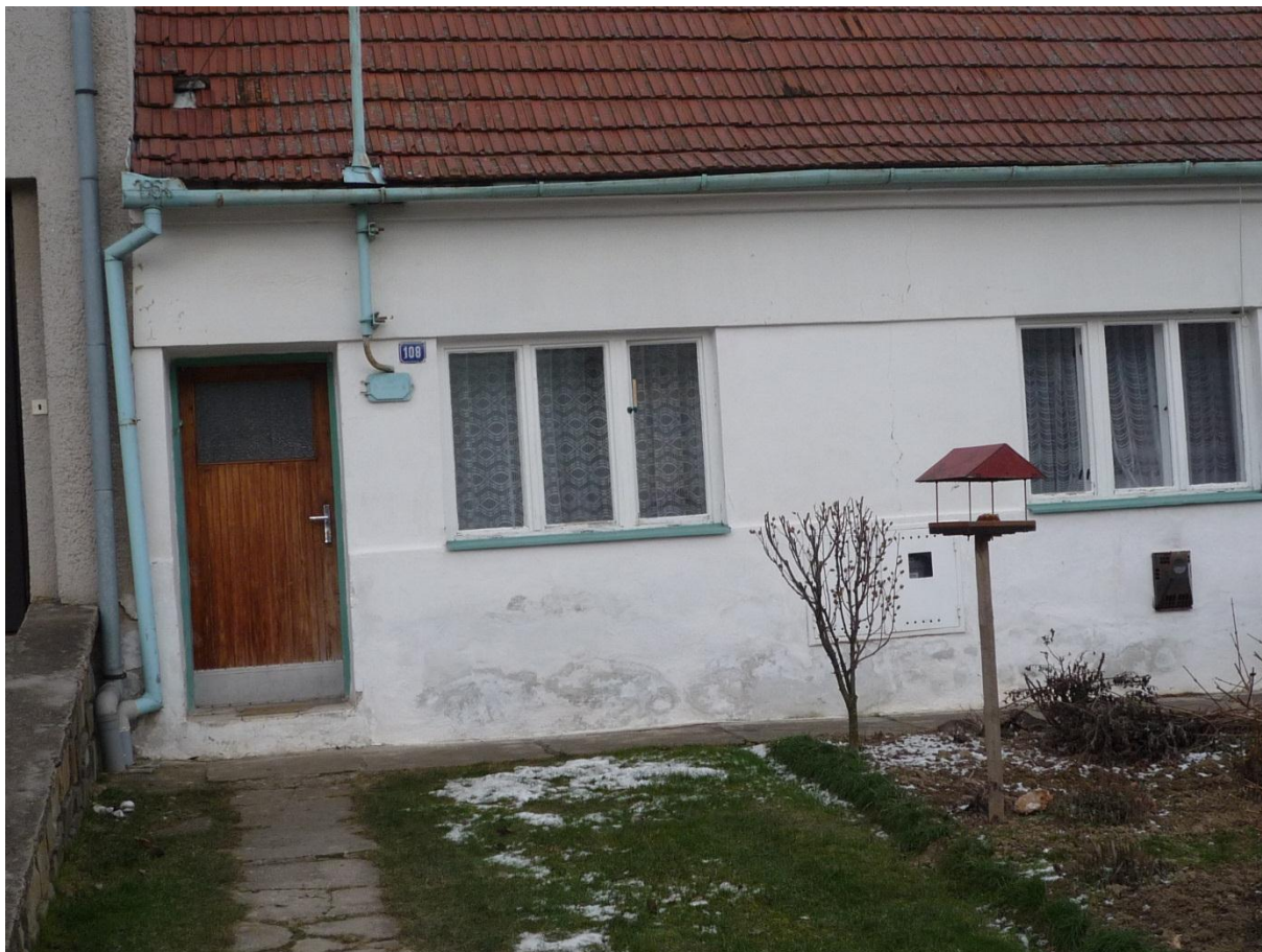
Obr. 5 – Zemní vlhkost vztlínající do zdiva
