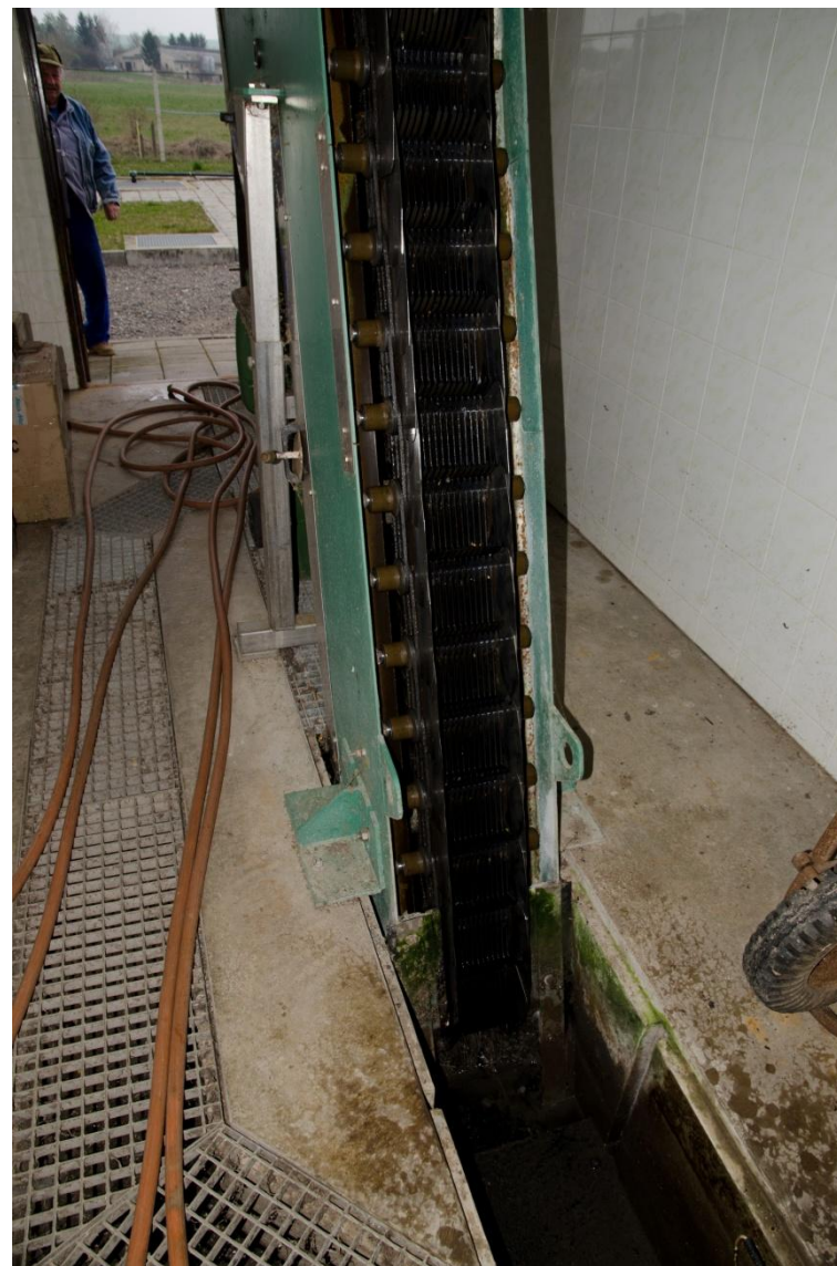
Fotografie č. 5 – Strojně stírané česle ČOV Letonice (archiv autora)
