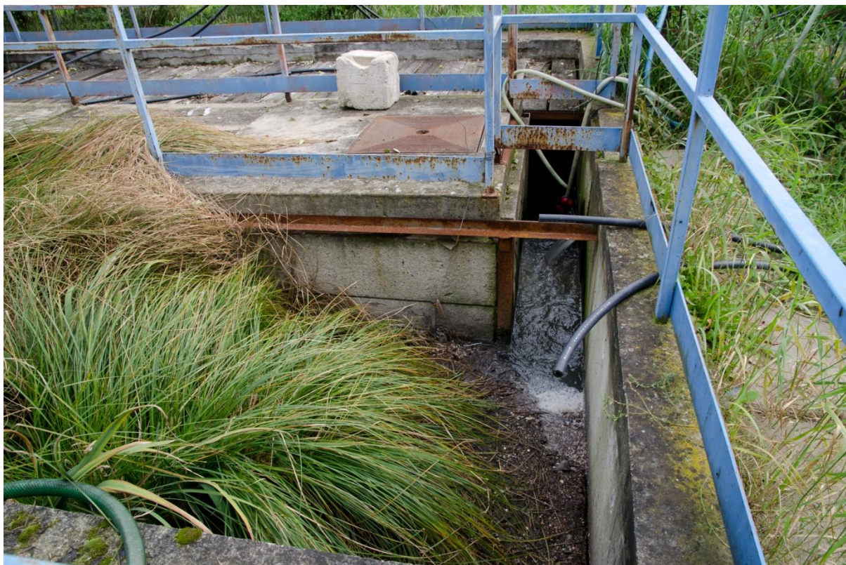
Fotografie č. 3 – Pohled do usazovací nádrže KČOV Dražovice (archiv autora)
