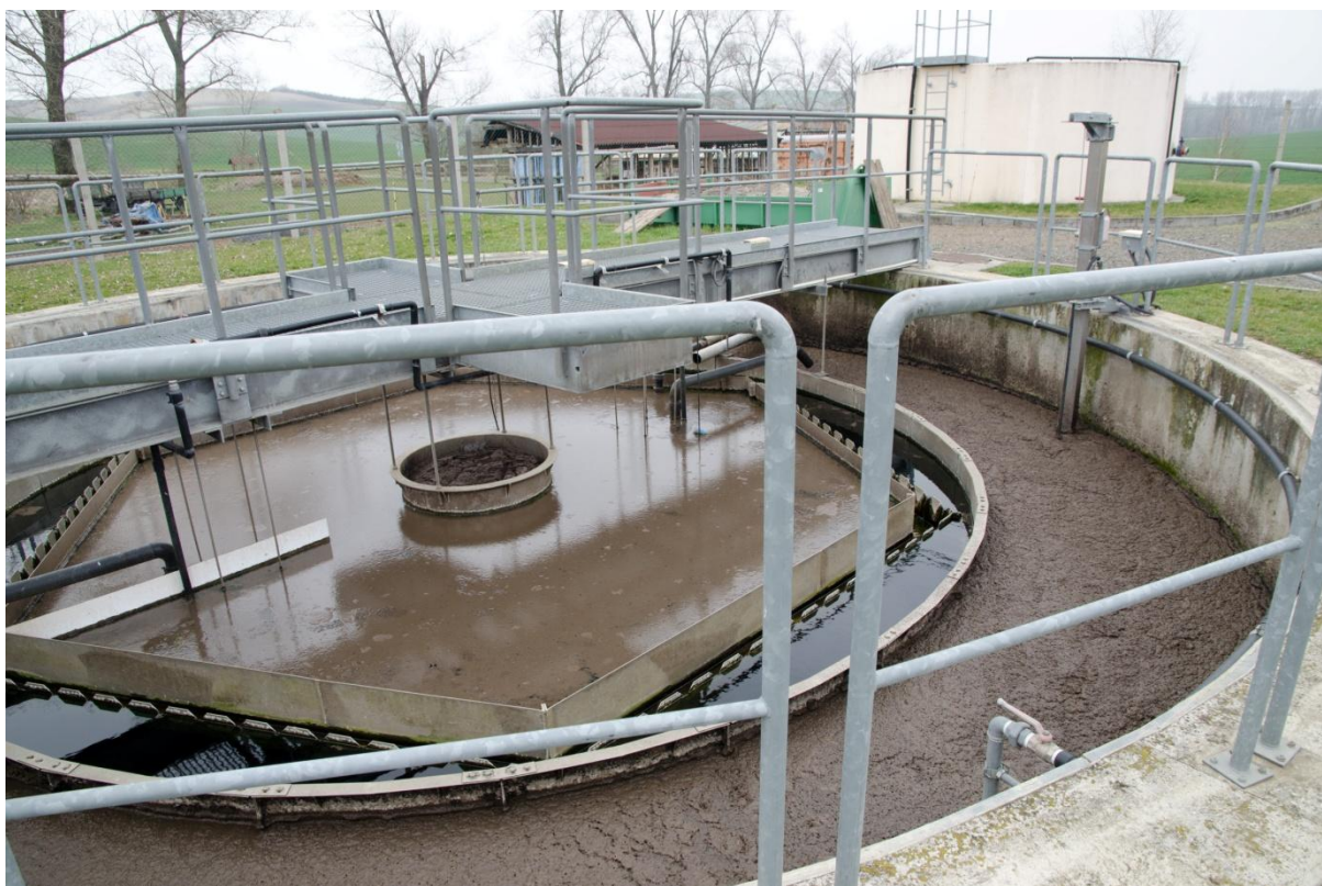
Fotografie č. 8 – Pohled na biologický stupeň ČOV Letonice (archiv autora)
