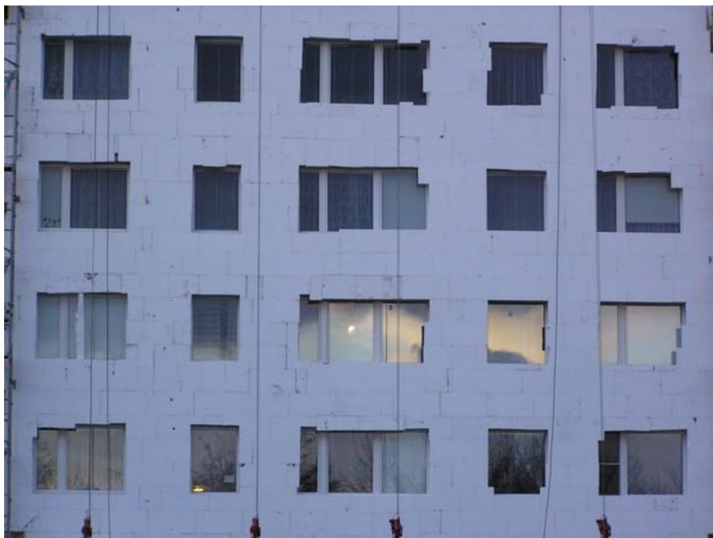
Obr. č. 14 – Chybné provedení zateplovacího systému obvodových stěn [33]
