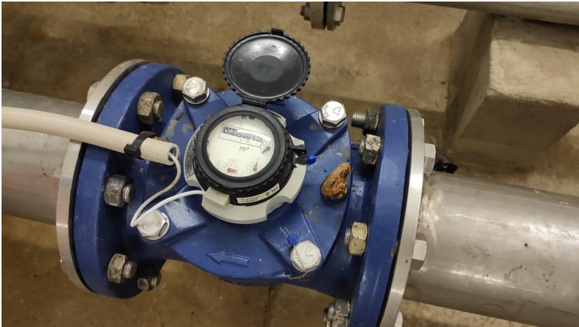
Obrázek 3.15 Měření průtoků v armaturní komoře vodojemu
