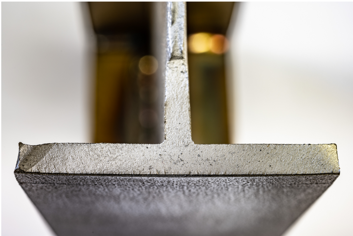
Obr. 2.45: Detail nosníku v místě porušení trhlinou
