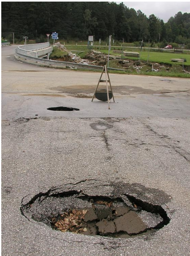
Obrázek 14: Vymletá díra v komunikaci
