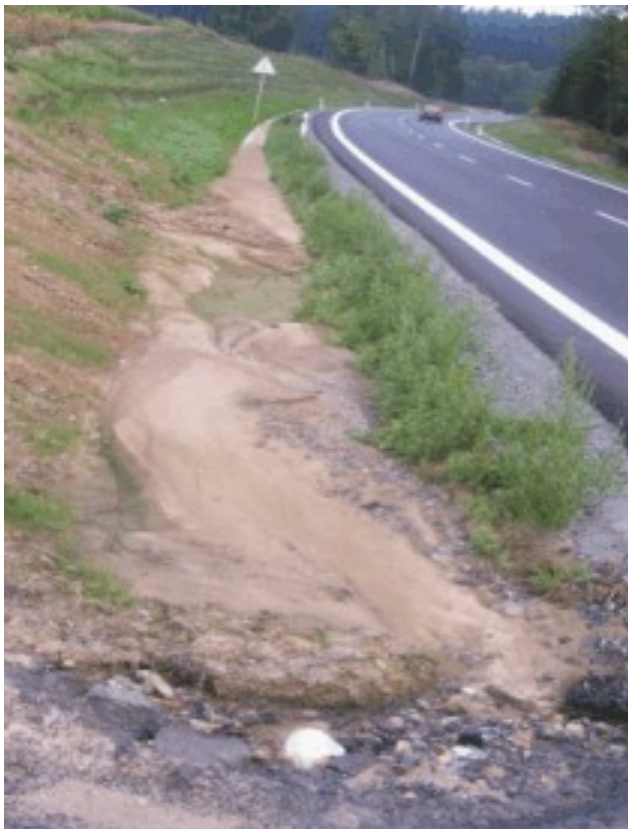
Obrázek 5: Zanesená odvodňovací stoka podél komunikace
