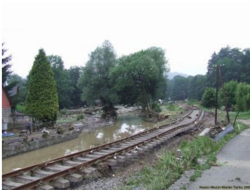
Obrázek 12: Vodou poškozený kolejový násp
