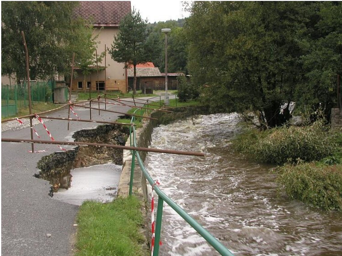
Obrázek 3: Erozi narušená komunikace
