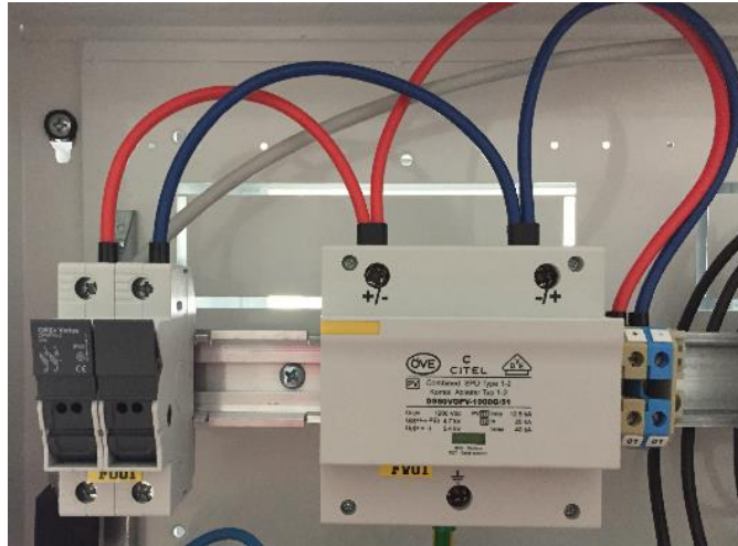
Obrázek 8: DC část rozvaděče (pořízeno v laboratoři UEEN)
