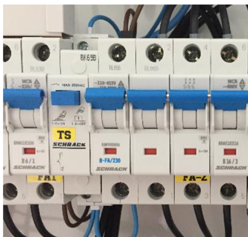
Obrázek 15: Vyrážecí spoušť u jističe zálohované části a central stop tlačítko (pořízeno v laboratoři UEEN)
