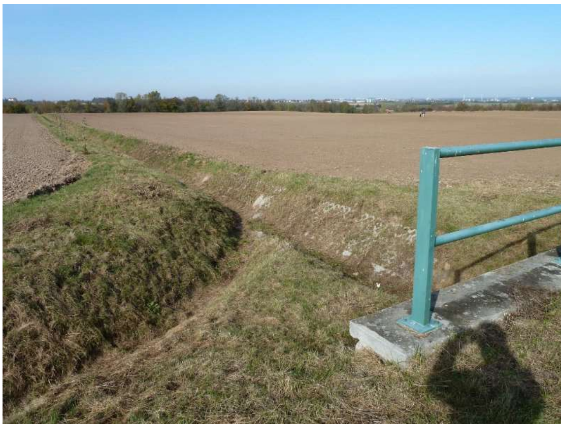
Obr. 8: Příkop délky 0,2635 km se napojuje na záchytný příkop A v místě křížení s cestou C1. Příkop je zatravněn. (HYDROPROJEKT CZ, a.s., 2010)
