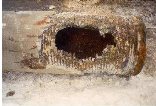
Obr.14 Součást napadená korozí v půdě [13]
