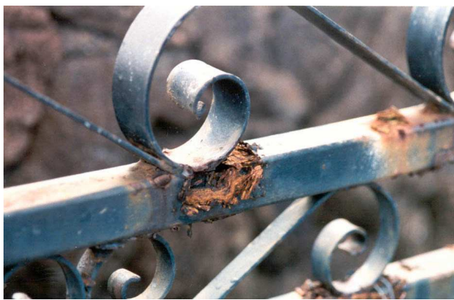
Obr. 11 Typické napadení atmosferickozu korozí [23]
