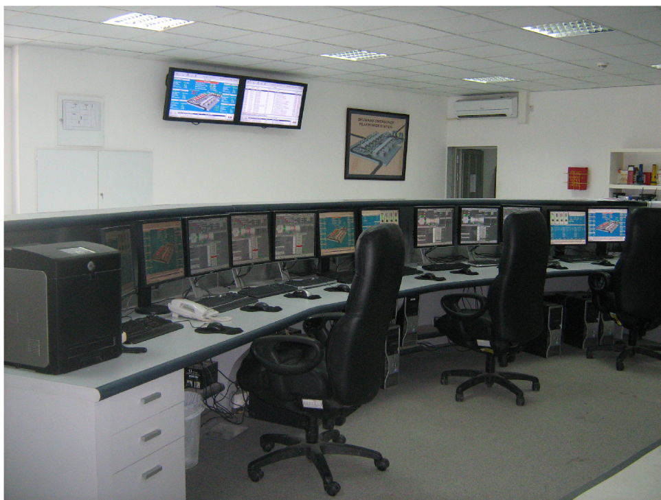
Obr. 1.2: Řídicí centrum Kuvajtské elektrárny[7].
