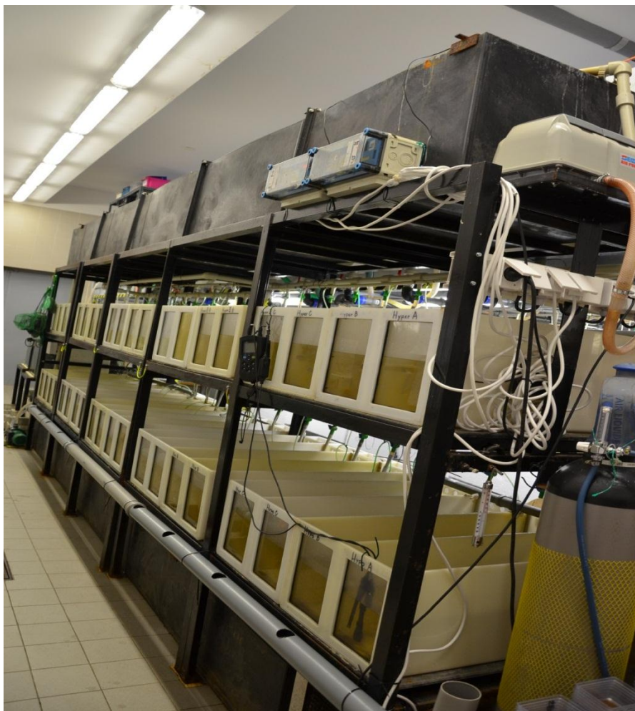
Obr. 4. Pohled na recirkulační systém
