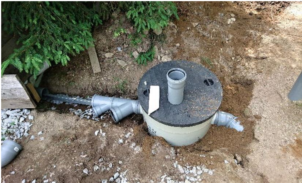
Obrázek 38: Instalace odkalovací nádoby.
