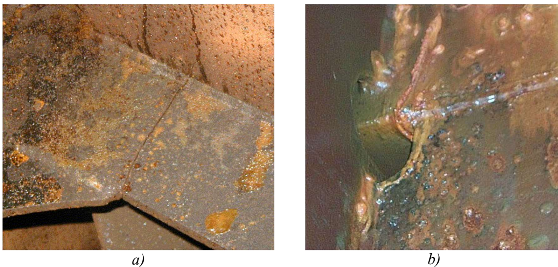
Obrázek 1.1 Porušení svarového spoje. [2]
