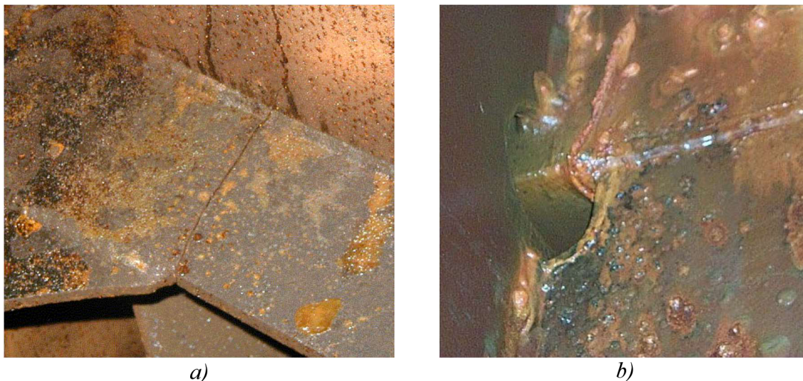
Obrázek 1.1 Porušení svarového spoje. [2]
