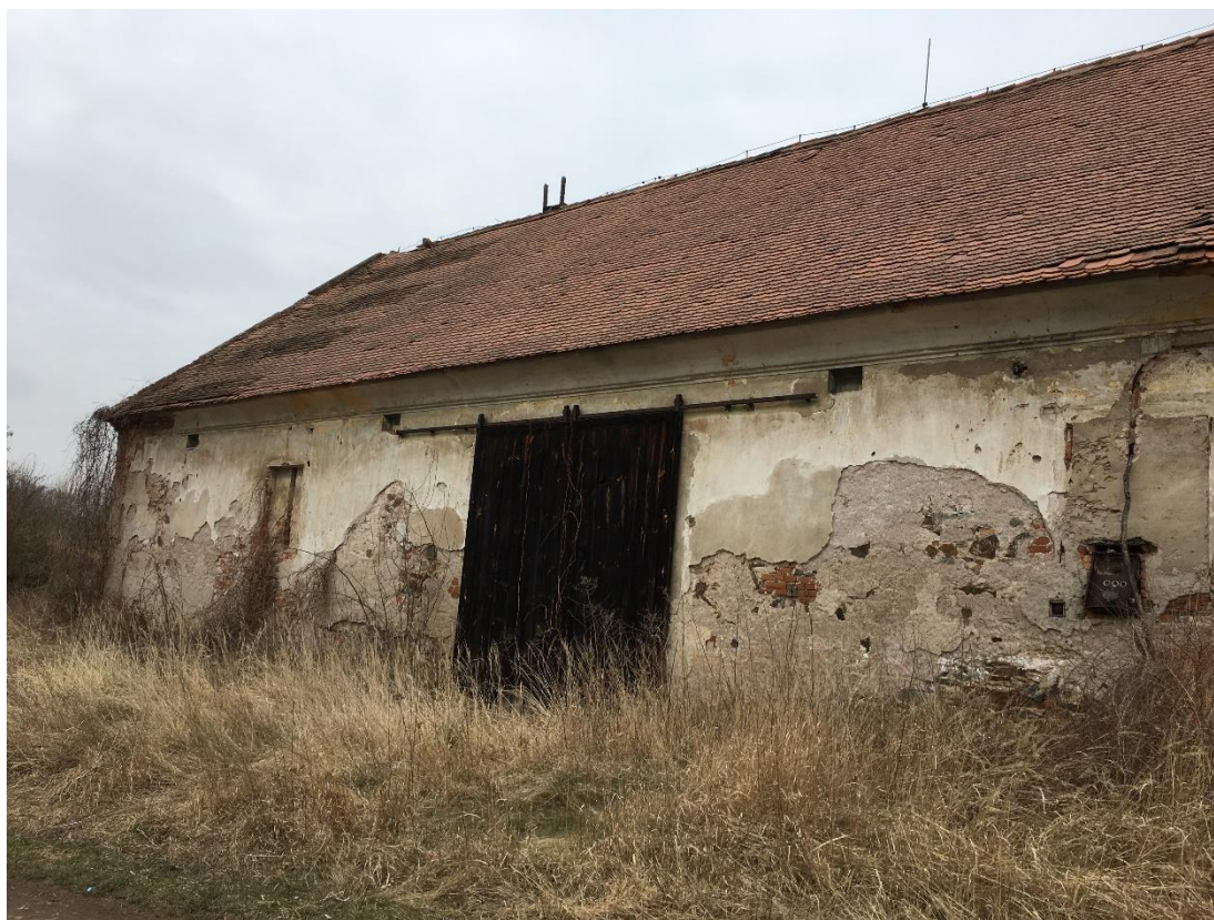
Obr. 13: Stodola v dezolátním stavu představuje pozůstatek stájového dvora
