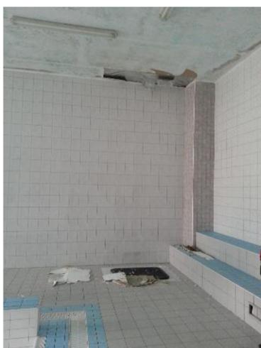
Obr. 1.1 Ukázka porušené konstrukce podhledu v bazénové hale
