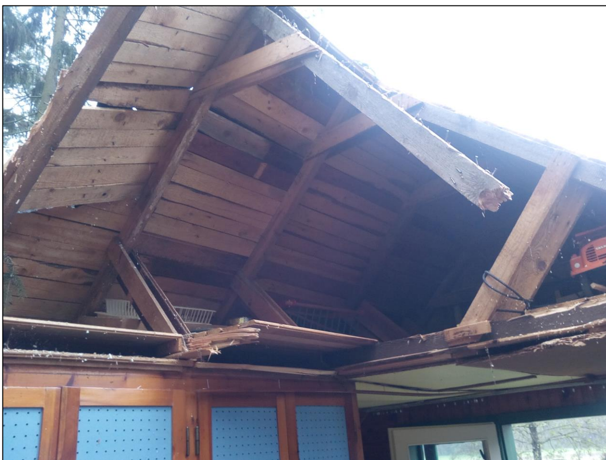
Obr. č. 10 – Detail poškozeného krovu a stropu nad 1NP [vlastní]
