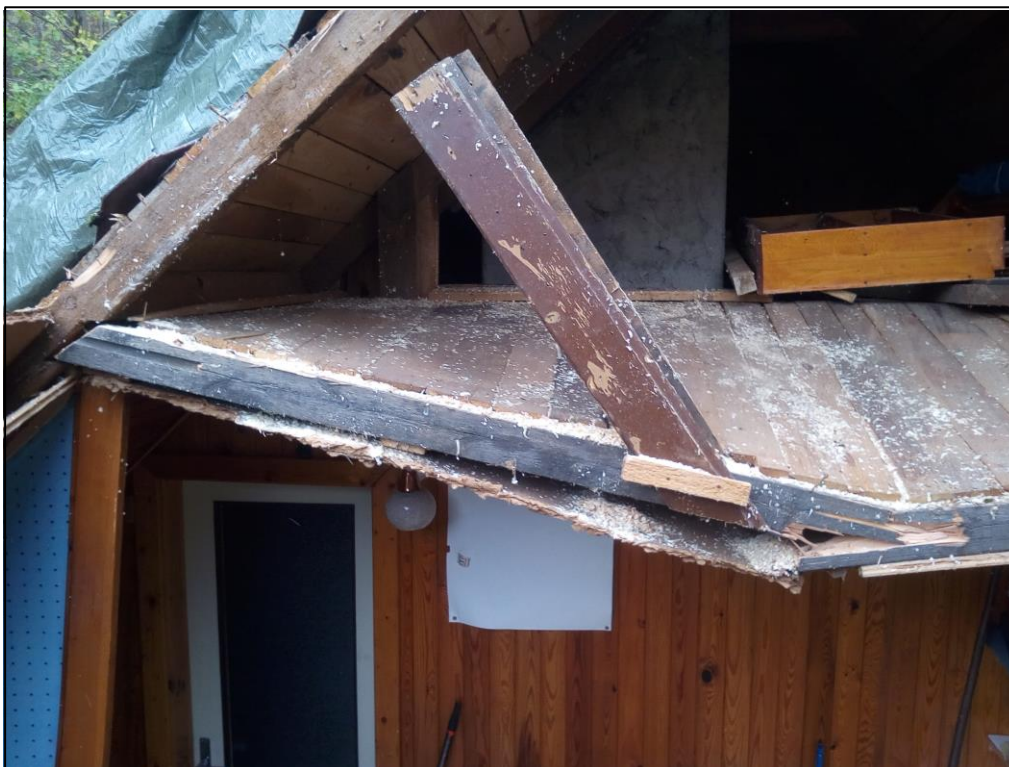
Obr. č. 11 – Detail poškození stropu nad 1NP [vlastní]
