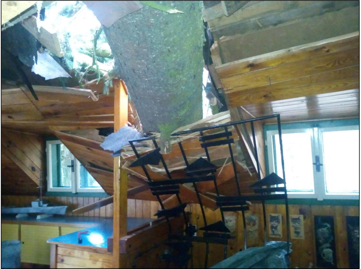
Obr. č. 7 – Detail poškození chaty kmenem stromu zevnitř [vlastní]
