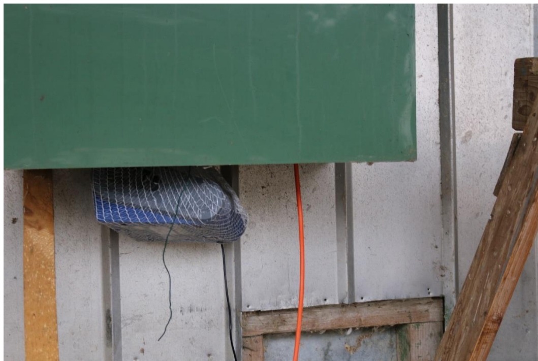
Obrázek – 15 Umístění přístroje v přívodní větrací klapce, zdroj: autor
