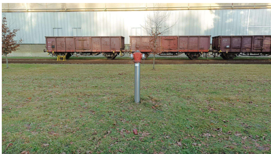
Obr. č. 12: Nadzemní požární hydrant – zdroj: vlastní foto
