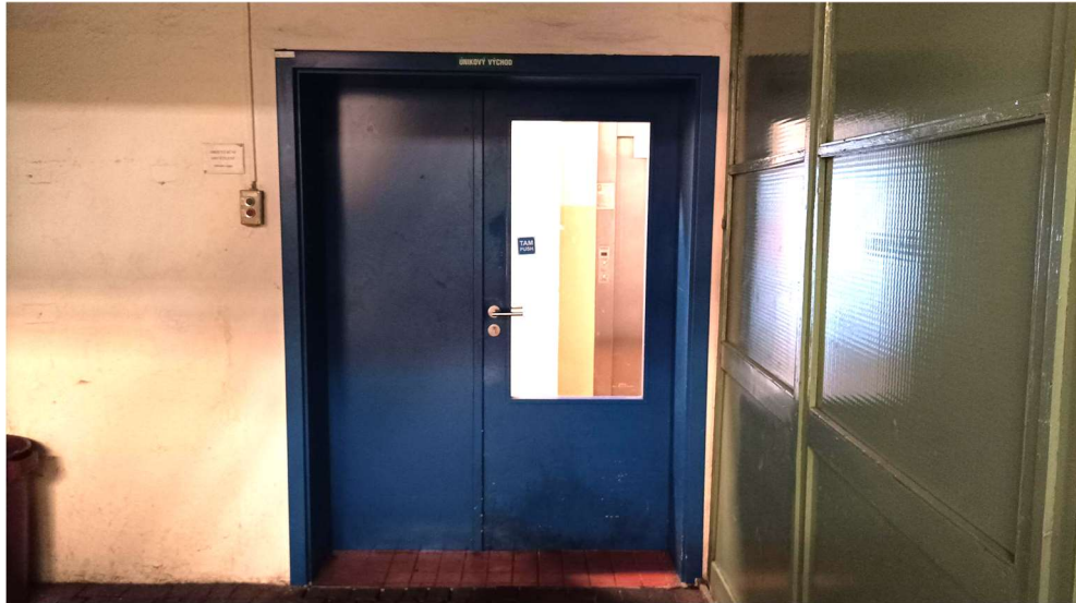
Obr. č. 13: Protipožární dveře – zdroj: vlastní foto
