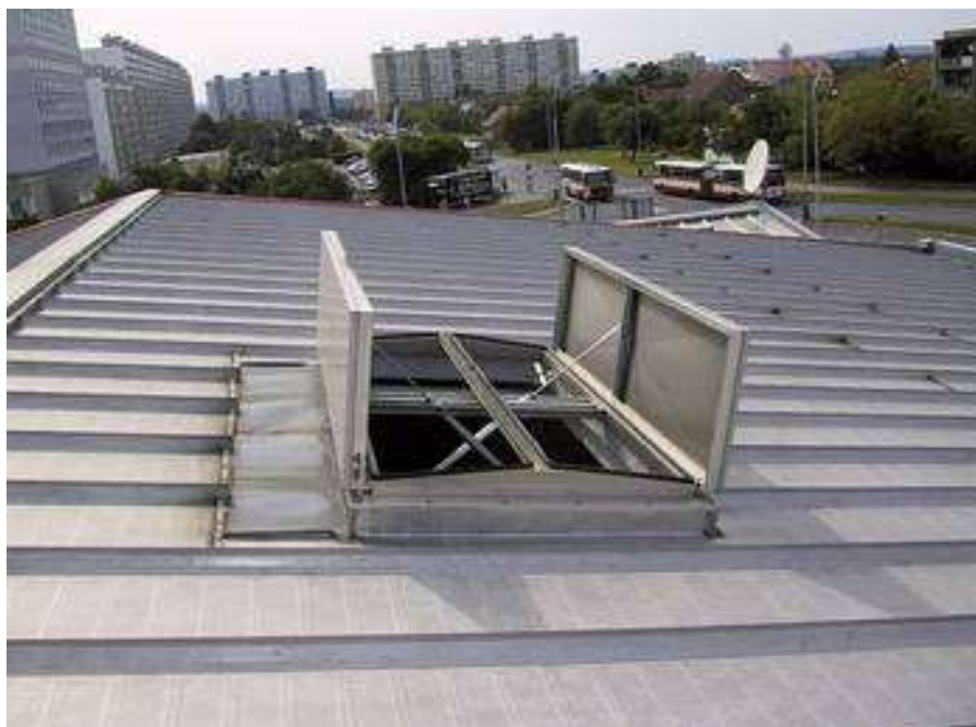
Obr. č. 10: Otevřené zařízení na odvod kouře a tepla 11
