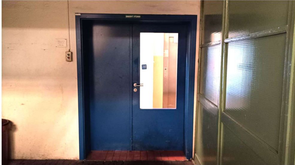
Obr. č. 13: Protipožární dveře – zdroj: vlastní foto
