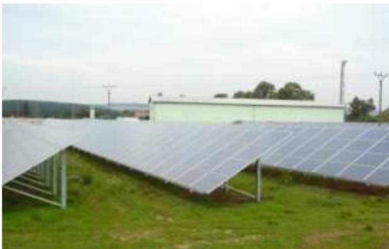
Obrázek 1: Fotovoltaická elektrárna Božerovice 18
