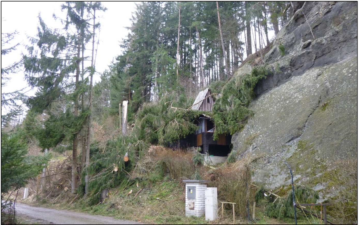
Obrázek 8.3 – Pohled na poškozený objekt po pádu stromu ze silnice [vlastní zdroj]
