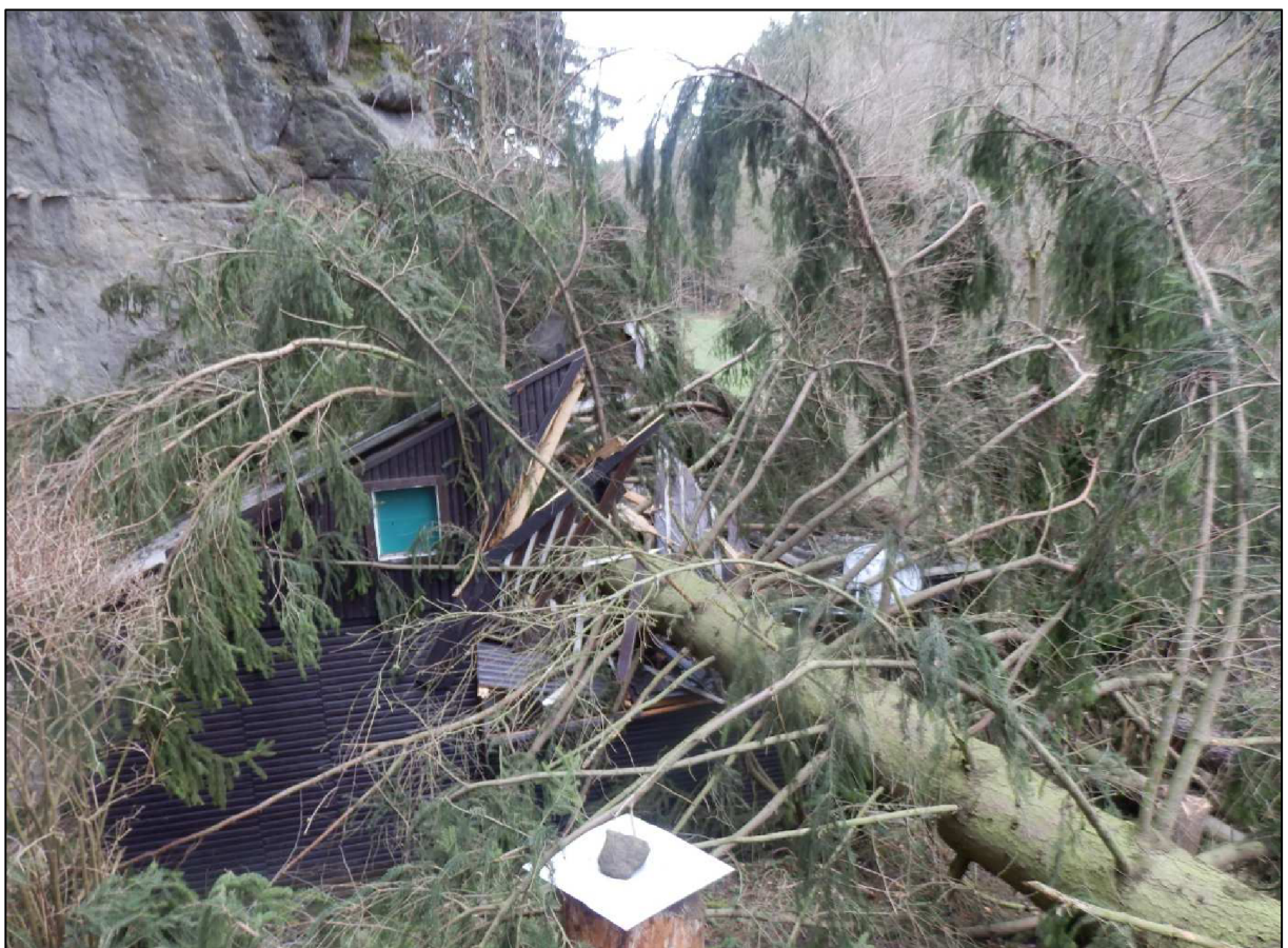
Obrázek 8.4 – Pohled na poškozený objekt po pádu stromu shora [vlastní zdroj]
